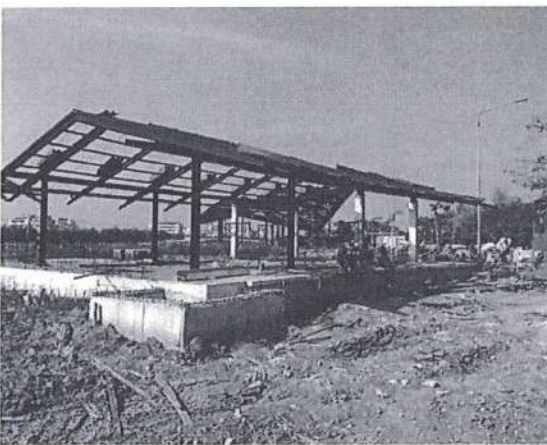
งานเตรียมมูลงหลังคา กลุ่มอาคารเรียนรู้อุ้ อยู่ระหว่างดำเนินงาน ในงวดที่ 7
